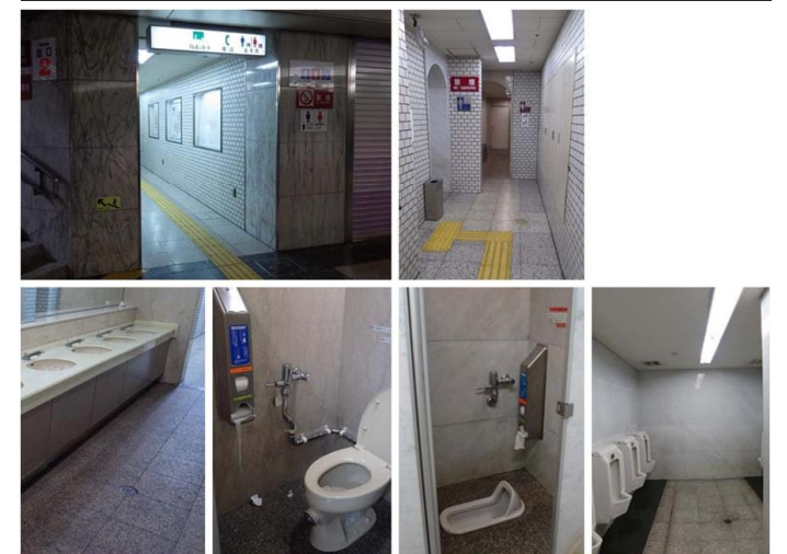
改修前のトイレは、和式便器が中心で、「使いづらい」という声も寄せられていた。トイレのサイン表示もわかりにくく、薄暗い雰囲気でも利用者も少なかった。
