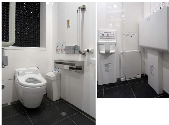
汚れやすい大便器の床の清掃性に配慮し、壁掛大便器・フラッシュタンク式を採用。男性1ヶ所、女性2ヶ所にひろびろブースを設置。ベビーチェアやベビーシートを備えて、乳幼児連れに配慮している。
